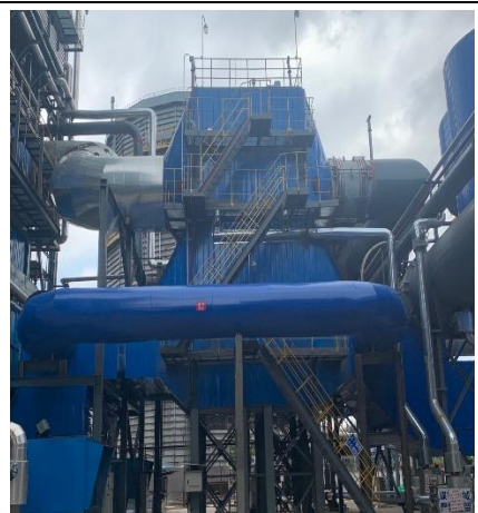
南侧锅炉脱硫塔
