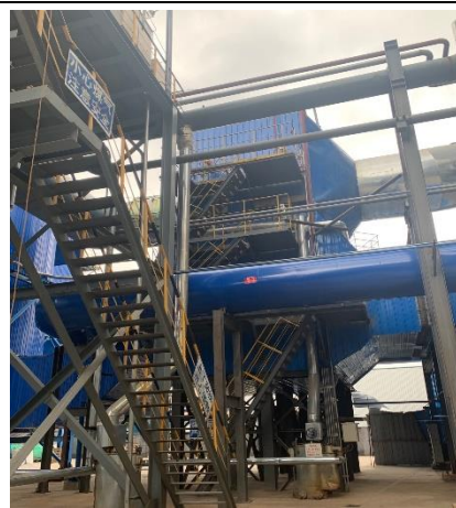
北侧锅炉脱硫塔
